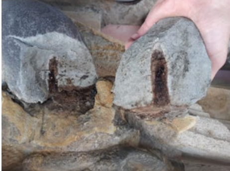
Koroze kovového čepu (v koleni sochy anděla) způsobila destrukci kamene Foto: Pavel Míka
